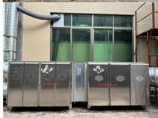
紫外線光解及活性炭吸附設備
